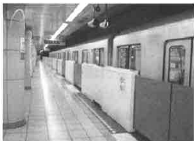
図3 可動式ホーム柵の設置例 出所) 国土交通省〔1〕
