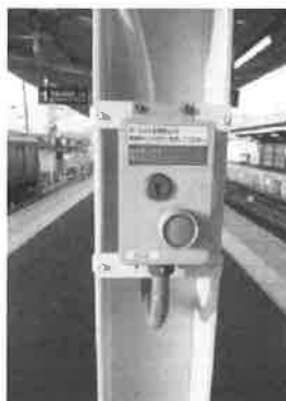
図5 非常通報ボタンの設置例
